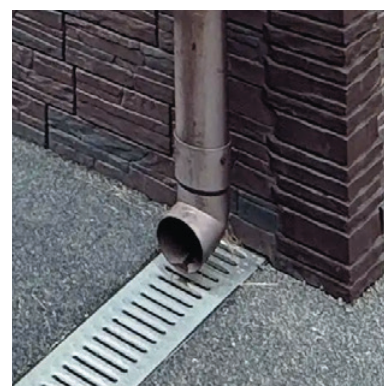
Нет зазора между панелью и отстойкой.
