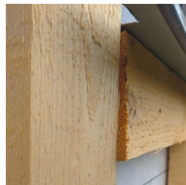
Обрешетка не в плоскости. Перекрыт вентиляционный канал.
